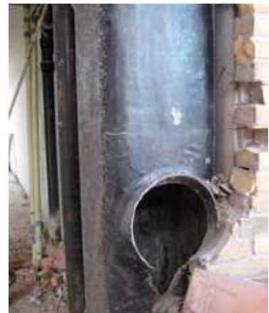
Her ses et affaldsrør med asbest.
