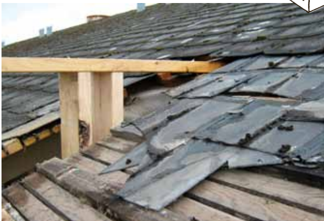
Skiffereternittag med asbest.
